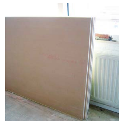
Platen tegen de muur
